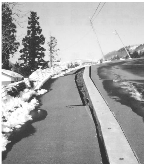
(亀裂が生じた村道)
